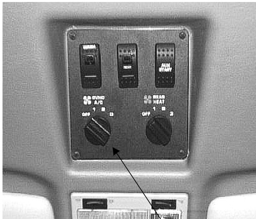
Overhead A/C Fan Control
